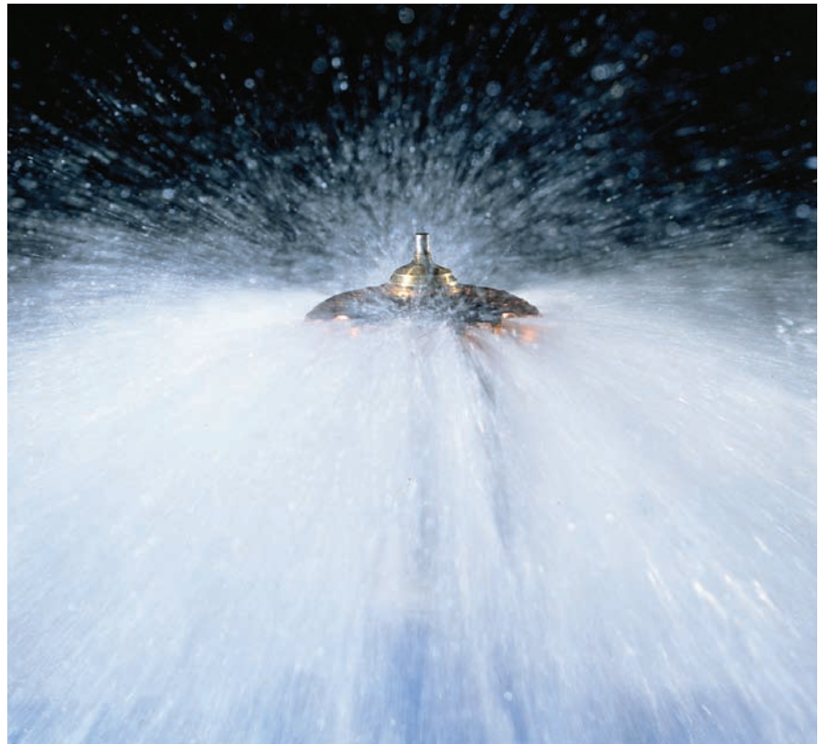
Sprinklerschutz ist abhängig vom Schutzziel und muss mit dem Regalbauer abgestimmt werden.
