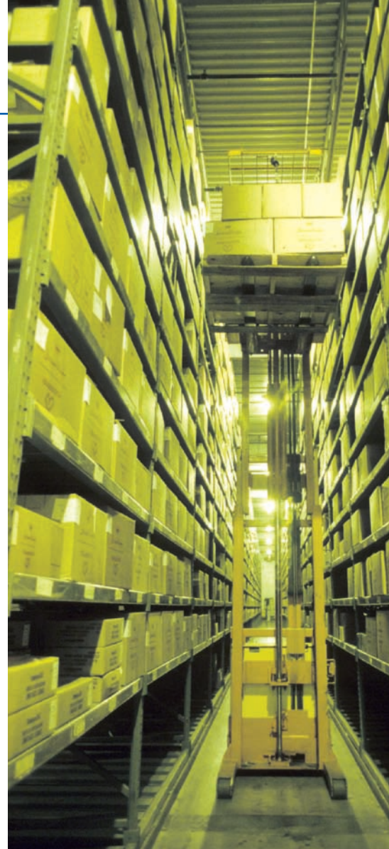
Regale mit Sprinklerschutz verringern auf den ersten Blick die zur Verfügung stehenden Palettenplätze. Bilder: FM Global
