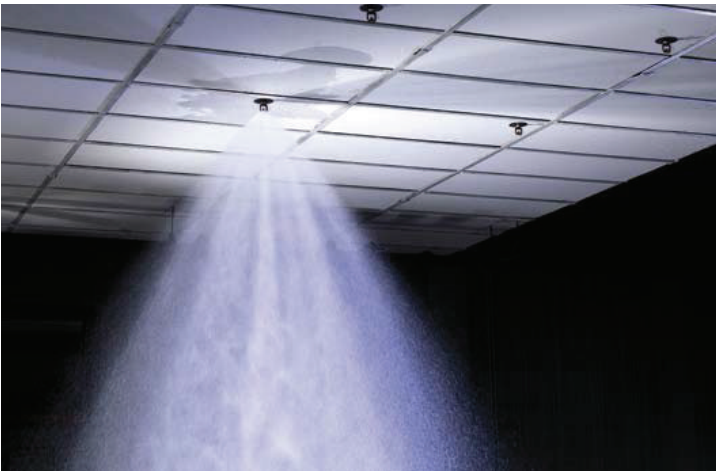
Sprinkler gehören zu den wenigen Sicherheitsvorrichtungen, die ohne Strom auskommen.
