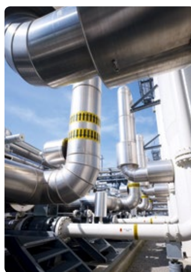
Erdgasuntergrundspeicheranlage von CAC in Haidach, Österreich
