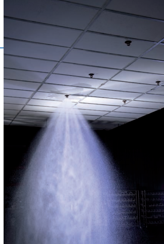
Sprinkler gelten als effektivstes Mittel der Brandbekämpfung und Schadenverhütung.
