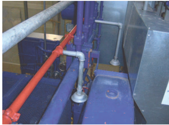
Detailaufnahme einer durch eine Sprinkleranlage geschützten Maschine in der Papierindustrie. Die Sprinklerköpfe werden nah an die Risikostellen – in diesem Fall das Lager der Maschine – herangeführt, um frühzeitig reagieren zu können.
